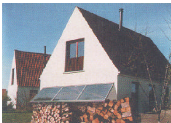
Solfanger som overdækning over brænde-stakken. Det kunne også være et halvtag over cykler, havemøbler el.lign.
